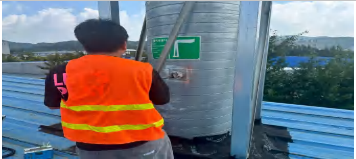
一车间排气筒 7DA012
