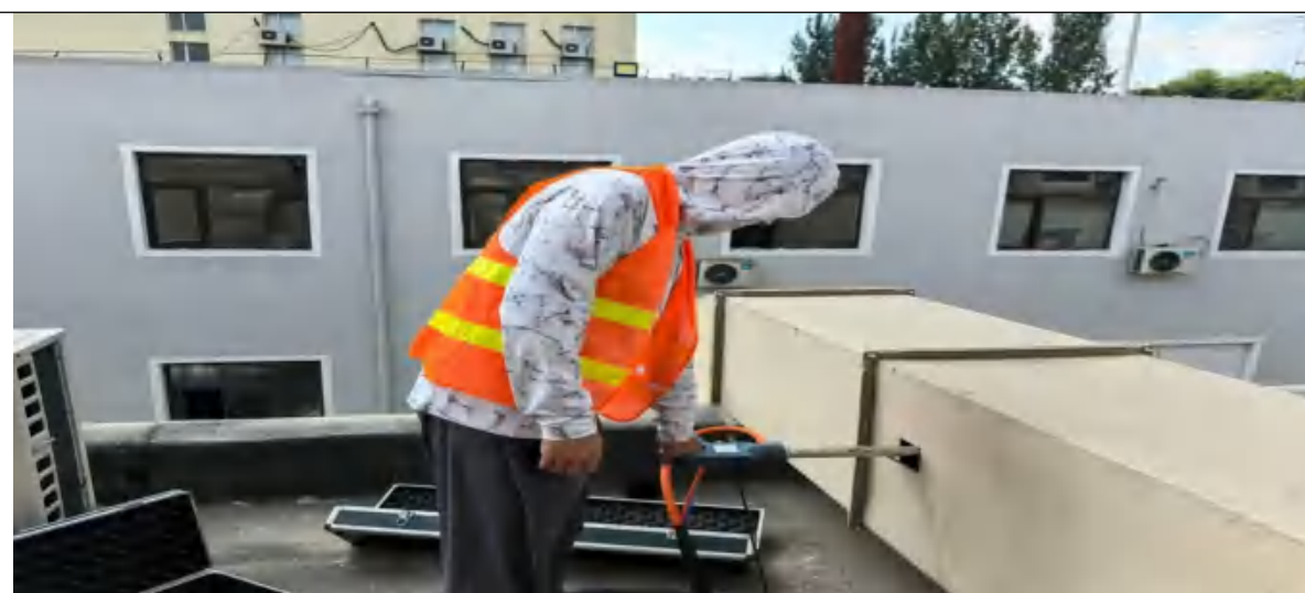
食堂油烟排气口进口
