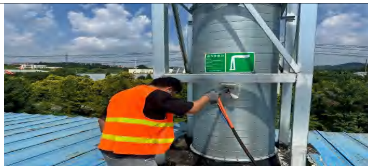
一车间排气筒 3DA008
