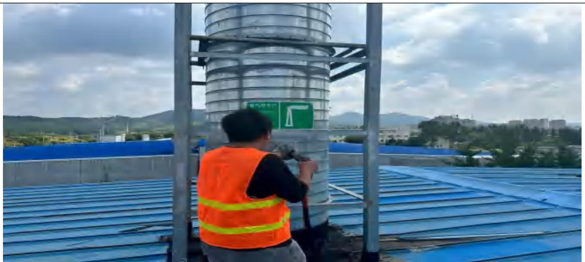
一车间排气筒 5DA010
