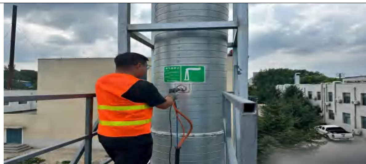
一车间排气筒 1DA006
