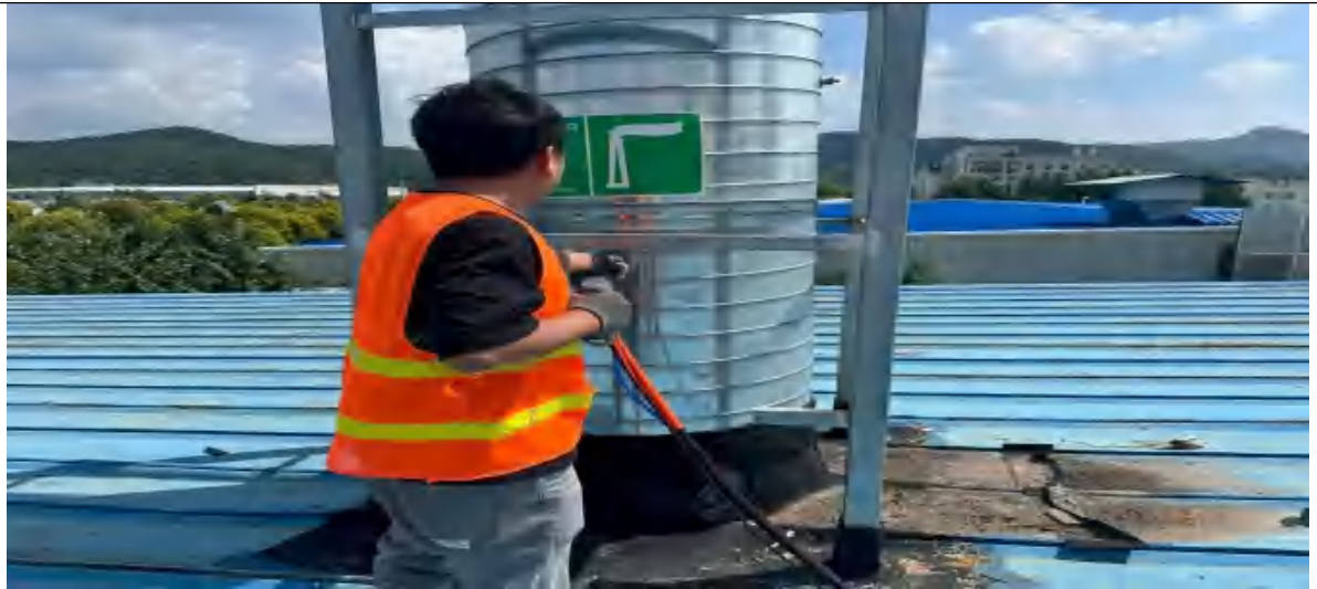
一车间排气筒 4DA009
