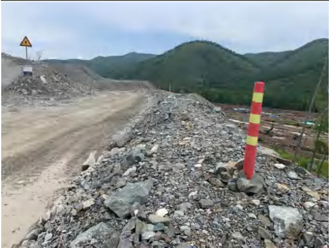
图 19:道路挡墙上反光杆
